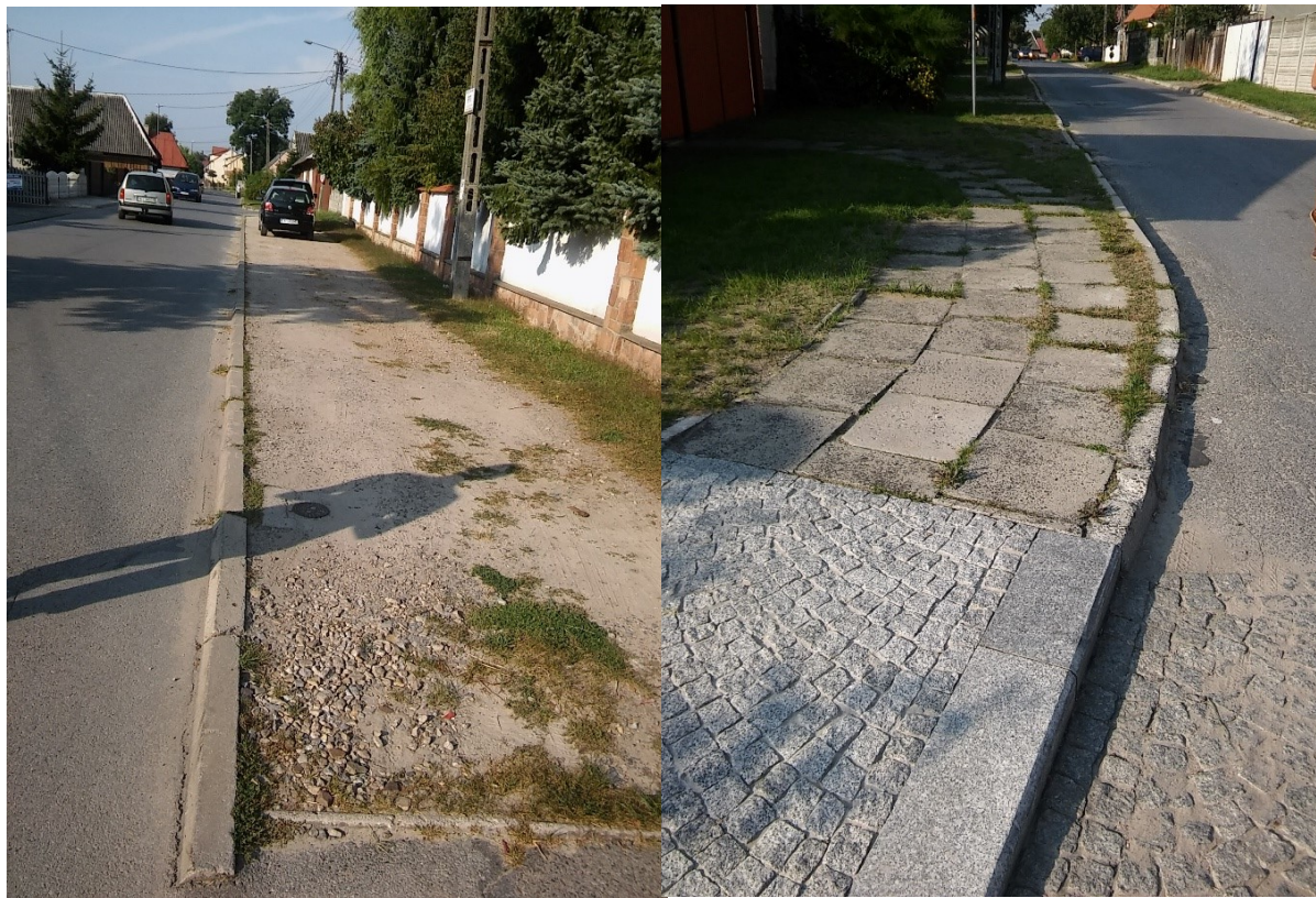
Daleszyce – potrzeba przebudowy i rozbudowy chodników (fot. P. Pietruszka – FRESH-BIZ)
